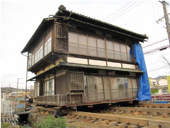
建屋を下で受けて架台にセット完了。 これをウインチで引っ張る。 家屋はガラス張りが多く、変形に弱い構造。
